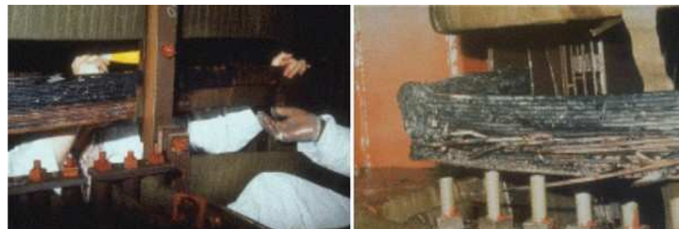
Figure 15 - Dommages irrémédiables provoqués à la centrale nucléaire de Salem (New Jersey) par un orage géomagnétique le 13 mars 1989 (Photo PSE&G Source : NASA)
